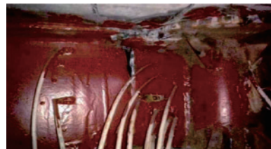
图9 钢箱梁腹板撕裂缺口
