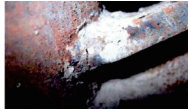
图5 交叉斜撑焊缝裂痕
