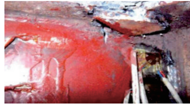
图6 箱翼缘焊缝断裂
